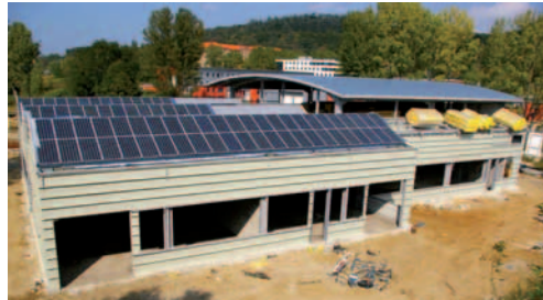
Un bâtiment HQE : 144 panneaux photovoltaïques (soit 130 m 2 ) ont été installés sur la toiture
