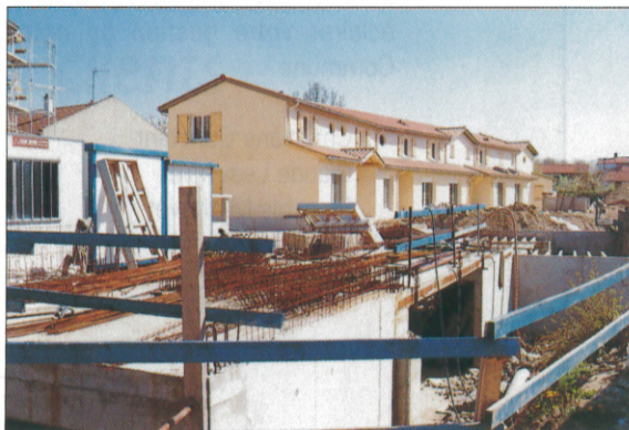
Secteur de la rue de Ronde : en cours de réalisation, les parkings en souterrain.
