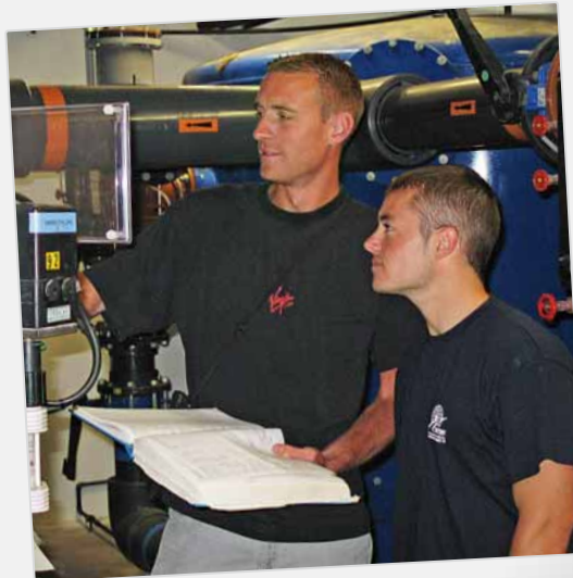
Le personnel technique, à l'image de Eddy et Sylvain, s'occupe de l'entretien des installations.
