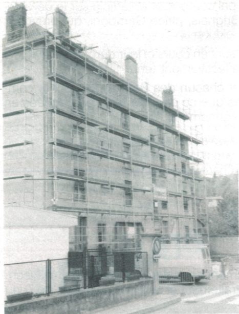
Immeuble 17, rue Simondon. Réfection zinguerie, chéneaux, cheminées. Ravalement en peinture des façades.
