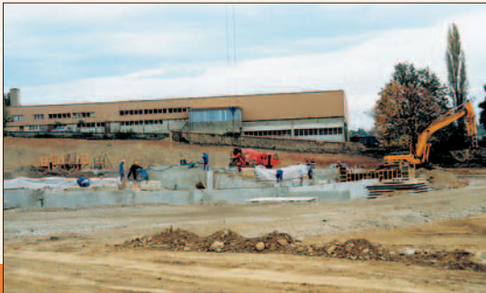
La construction du multiplexe cinématographique est lancée. Il ouvrira les portes de ses 15 salles en avril 2000 avec une capacité de 3290 fauteuils. ■
