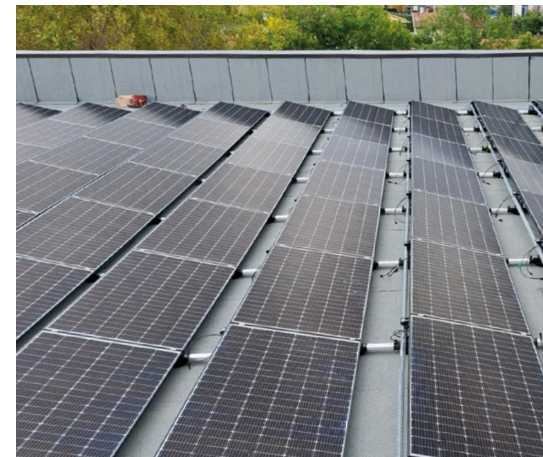
Installation photovoltaïque sur la toiture du groupe scolaire Jean-Moulin.
